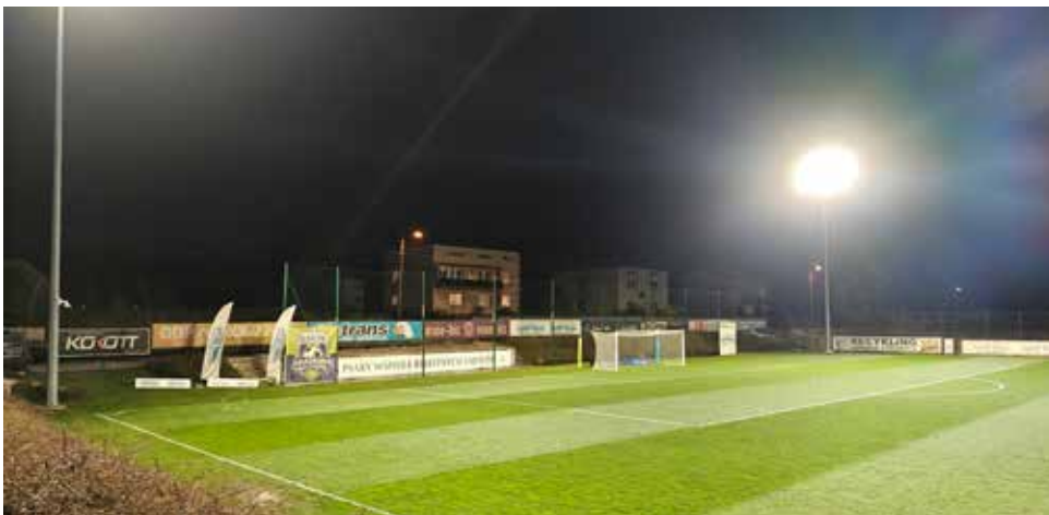
Zmodernizowano oświetlenie na stadionie w Sarnowie
