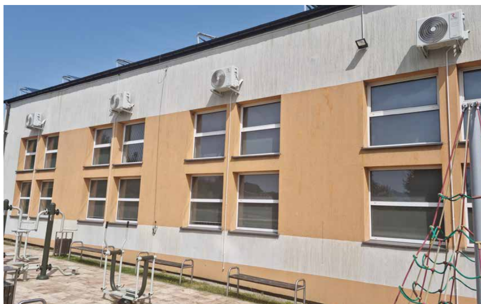
Dzięki funduszowi sołeckiemu w SP w Dąbiu zamontowano łącznie 8 klimatyzatorów
