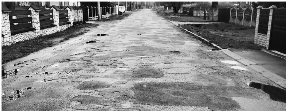
Nawierzchnia na ulicy Szkolnej w Preczowie jest w bardzo złym stanie
