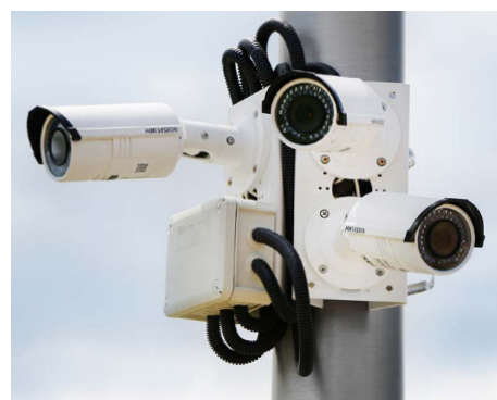
W gminie Psary zainstalowano nowoczesny monitoring
