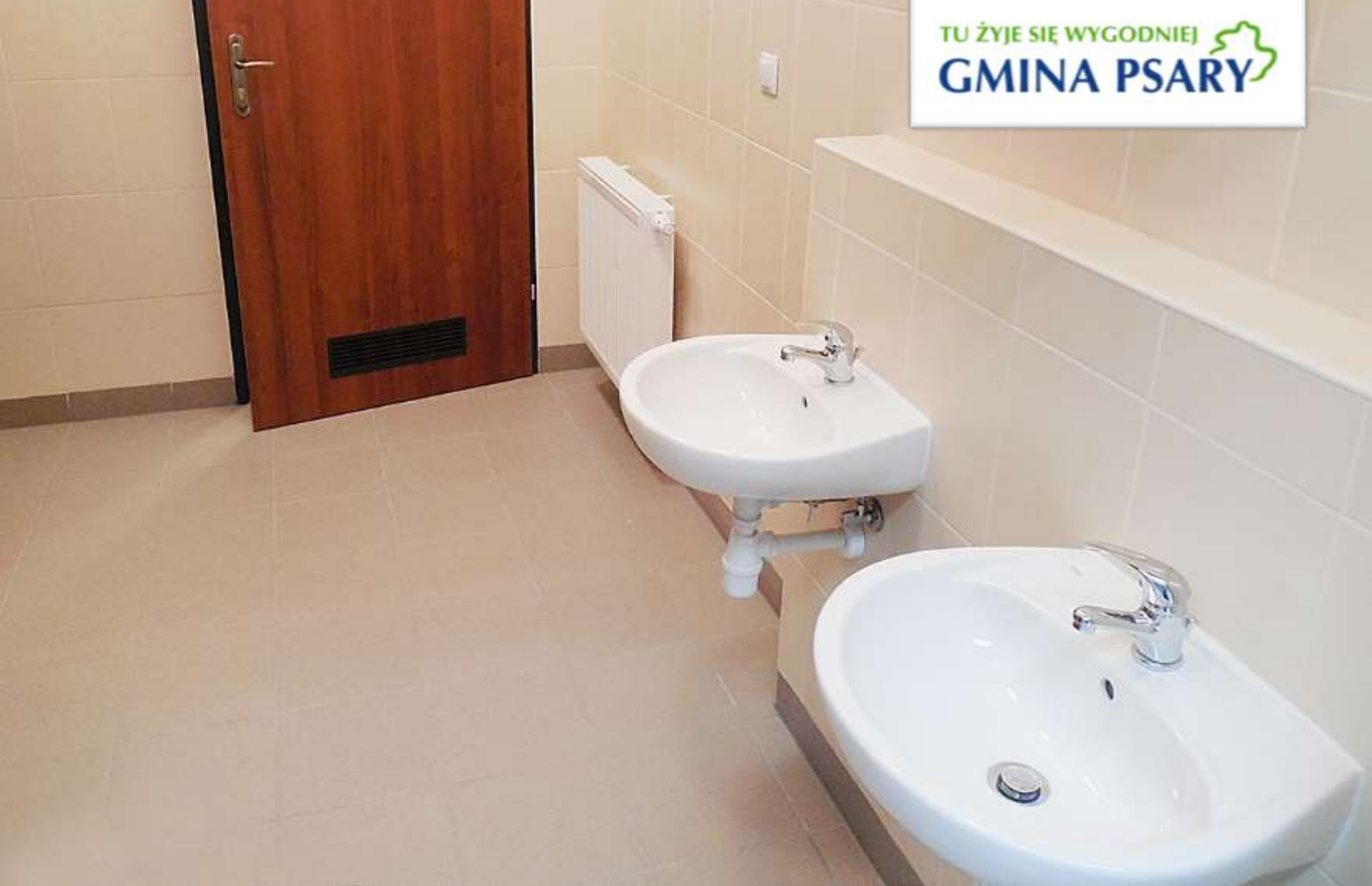
Nowe sanitariaty w rozbudowanym zapleczu OSP Dąbie.
